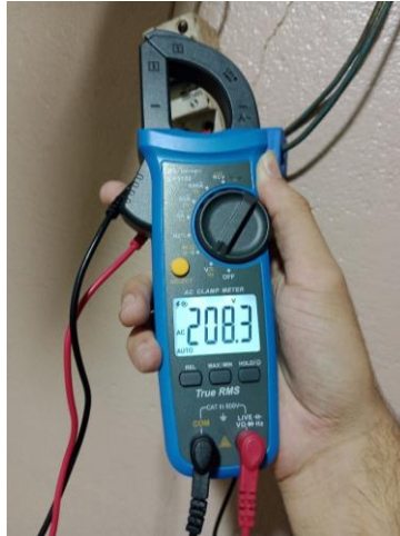
Figura 28: Medição da tensão com um multímetro diretamente no circuito do equipamento.
