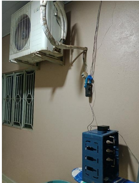
Figura 21 - Condensadora e sistema de monitoramento conectado ao cabo de fase.
