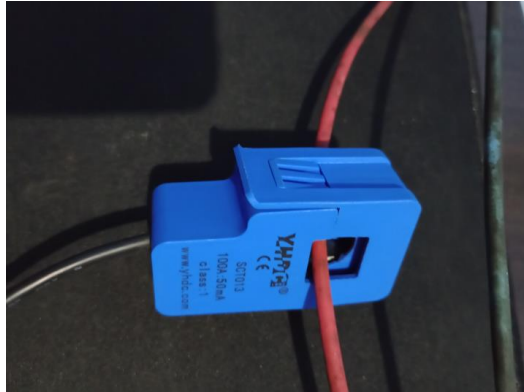
Figura 10 - Posicionamento do sensor SCT-013 no cabo de fase.
