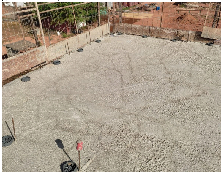
Figura 4.16 – Laje com fissuras devido à retração do concreto.
