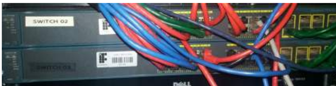
Figura 1 – Switches no Datacenter Fonte: elaborado pelos autores
