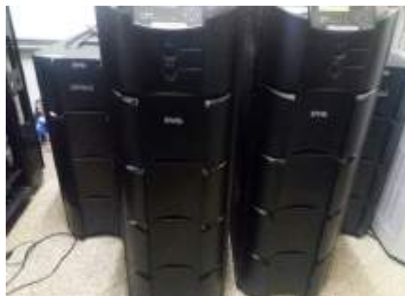
Figura 2 - Nobreaks do Datacenter Fonte: elaborado pelos autores
