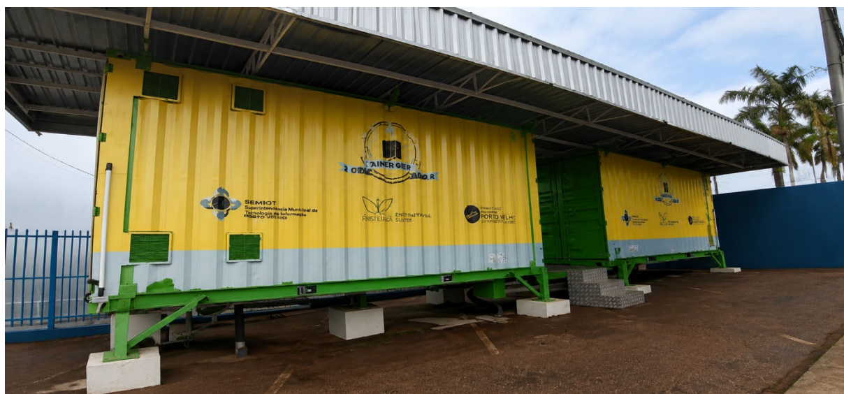
Figura 08 – container de armazenamento de dados e banco de baterias.
