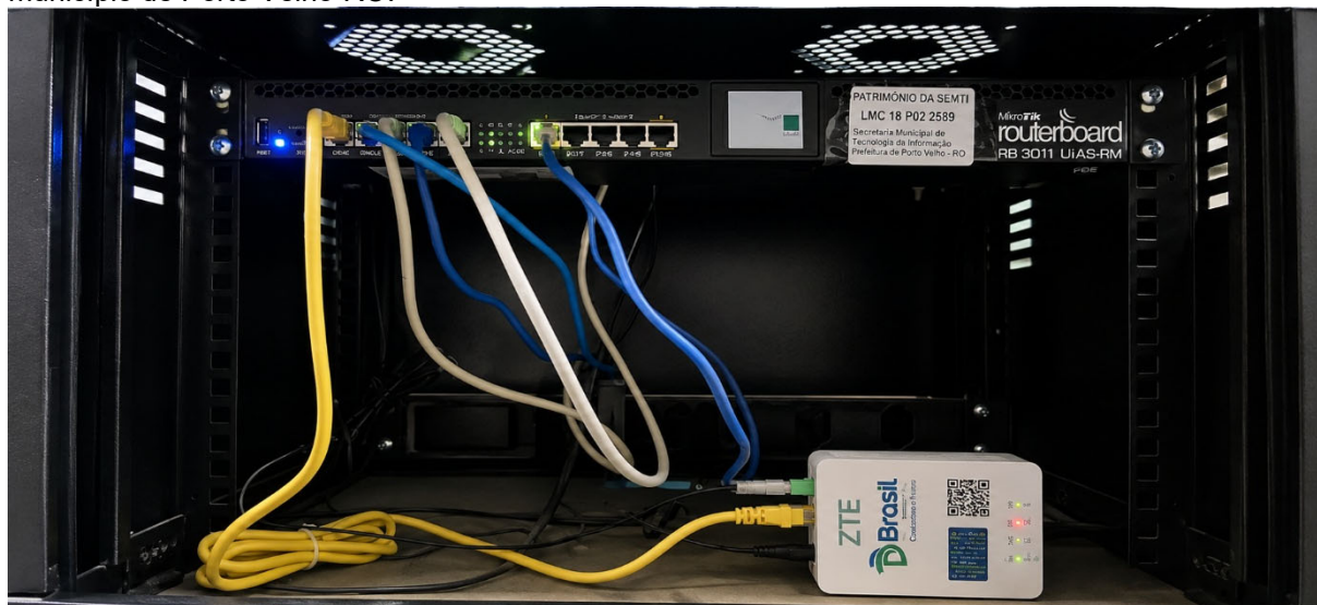
Figura 06- Gabinete com Switch e Conversor de fibra, unidade de Saúde Nova Aliança, zona rural do município de Porto Velho-RO.
