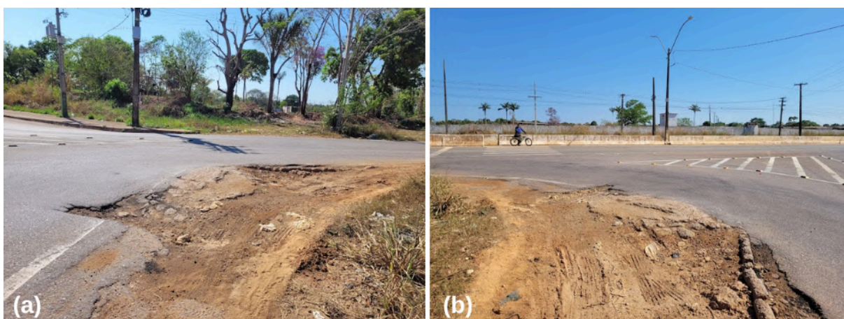
Figura 21 – Buraco na extremidade da curva da interseção.
