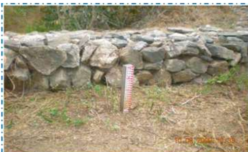
Barragem com sedimentos acumulados em mais de 1,10 m em 8 anos.
