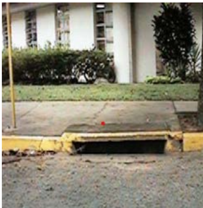
Figura 2 – Bueiro sem grade.
