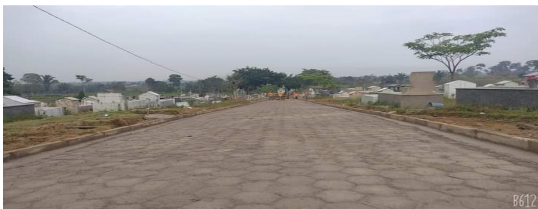
Instalação de bloquetes nas dependências do Cemitério Municipal de Buritis, facilitando o acesso dos visitantes aos túmulos de seus entes queridos.
