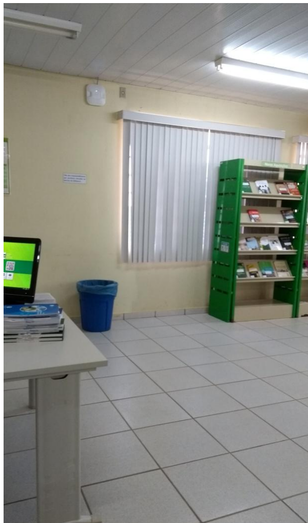
Imagem 9: Parede e piso sem contraste de cor.
