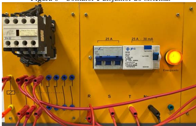
Figura 6 - Contator e disjuntor do sistema.
