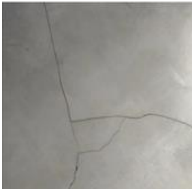
Figura 7 – Rachaduras no piso
