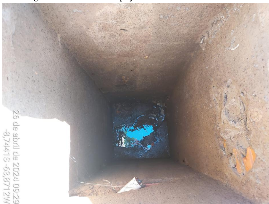
Figura 08 - Caixa de inspeção onde foi coletada a amostra
