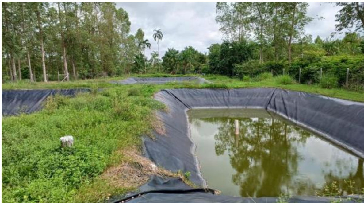
Figura 4: Fotografia de Tanques com necessidade de manutenção.
