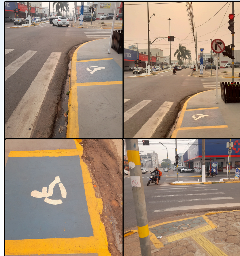
Figura 23: Rebaixamento inadequado de calçadas na Av. Major Amarantes
