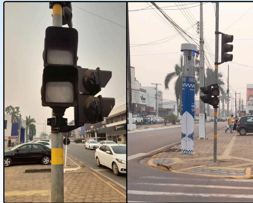
Figura 19: Sinaleiros de travessia de pedestres desligados
