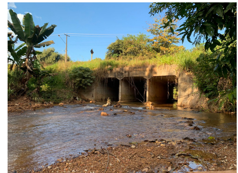
Figura 05 - Travessia canalizada no Igarapé Pires de Sá
