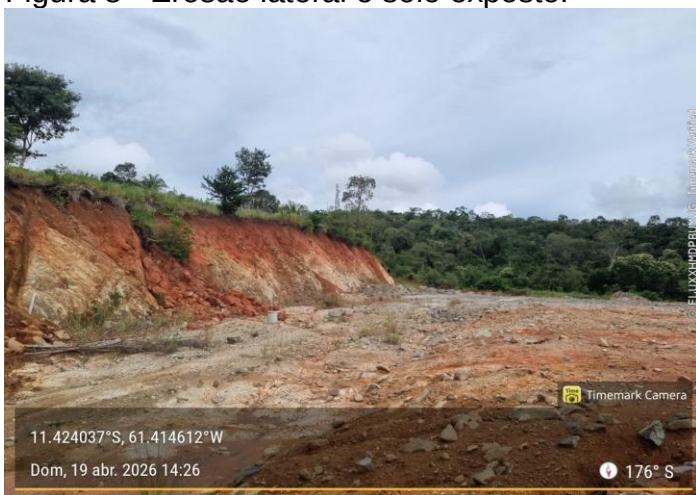
Figura 8 - Erosão lateral e solo exposto.
