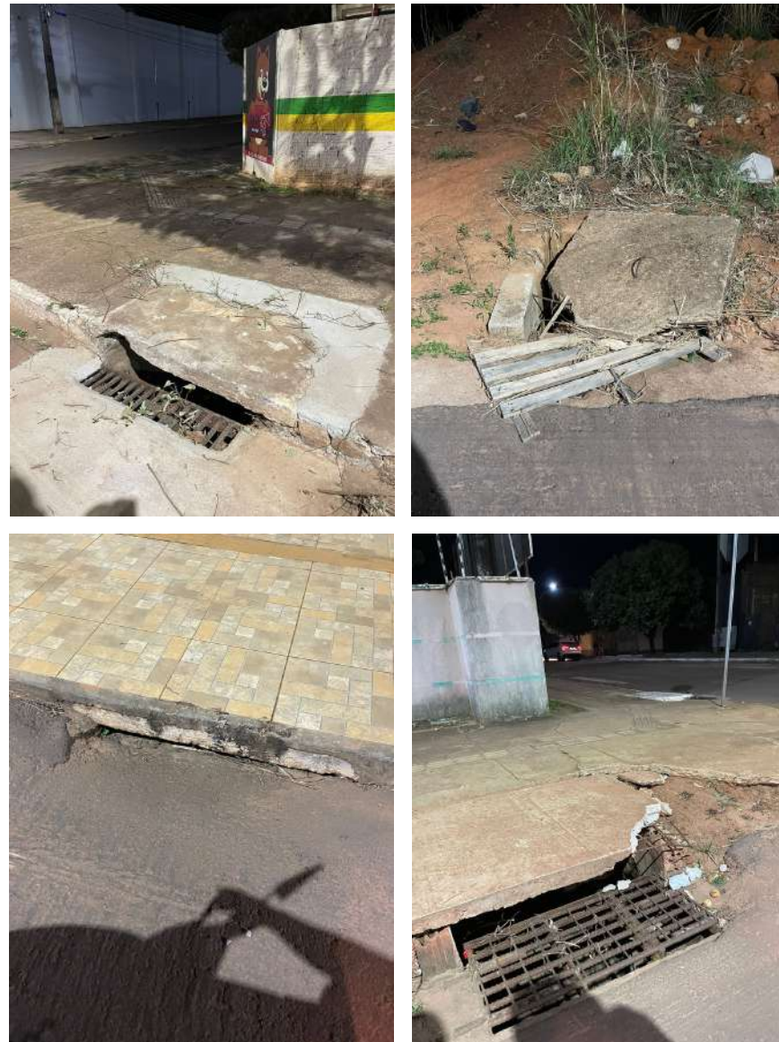
Figura 4: Bocas de Lobo obstruídas.
