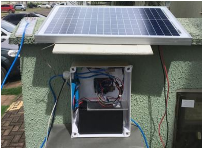
Fig. 18. Case temporário instalado em campo para o desenvolvimento do sistema de supervisão. Fonte: Autor.
